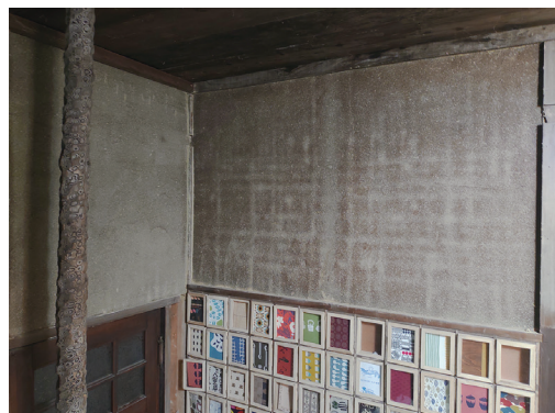
写真3 時間が経っておぼろげに木舞下地が浮かぶ土壁
