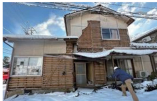
写真1 モルタル外壁の大規模な剥落
