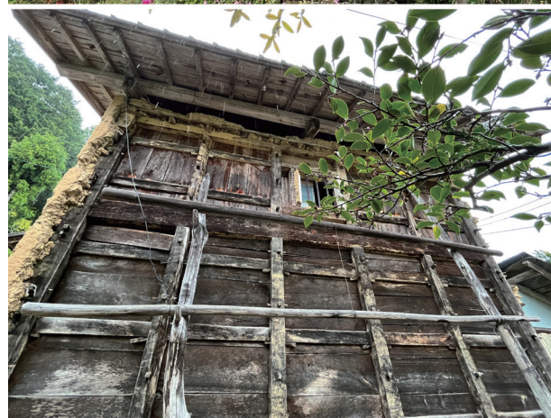
外観の様子。平側の土壁が崩落しており、木造軸組と落とし込み板壁が表しになっている。
