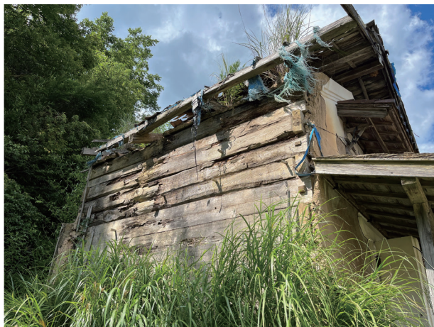
外観の様子。平側の土壁が崩落しており、井籠組の躯体が表しになっている。
