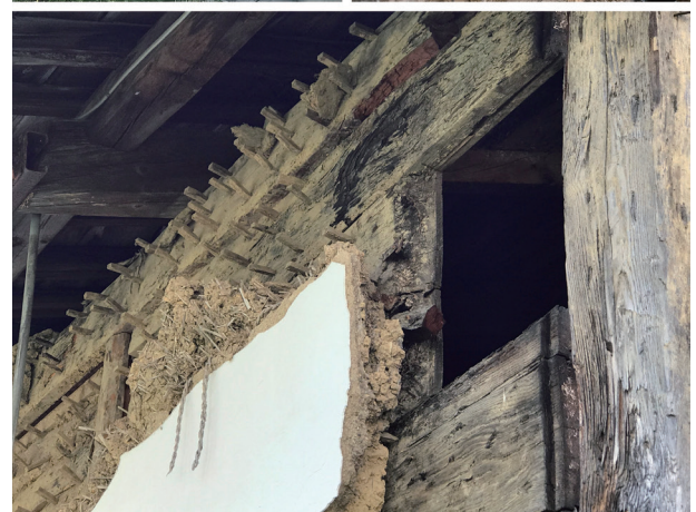
原村の土蔵の例。雨漏りのあった箇所から土壁が浸食され、剥がれ落ちている箇所がある。剥がれ落ちた箇所からのぞかせているのは「シャチ」と呼ばれる木杭。これに縄を絡ませて壁土を付けた様子が伺えた。
